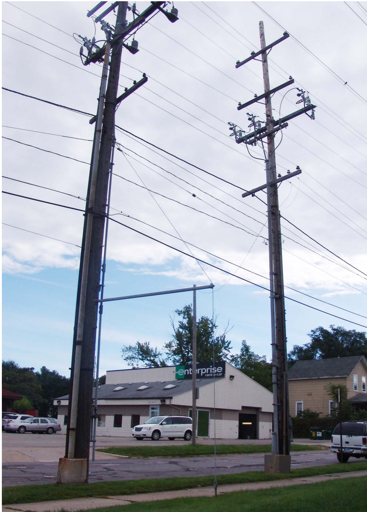
P11 Duct Riser
