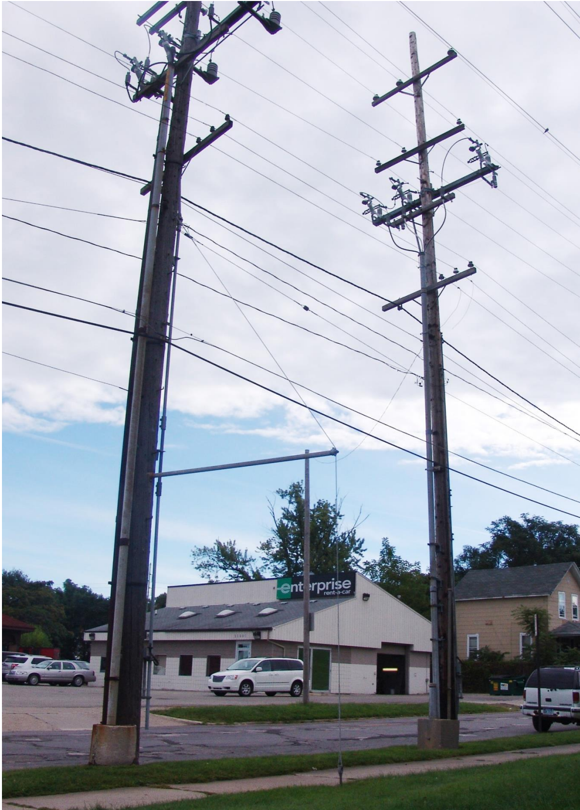
P11 Duct Riser
